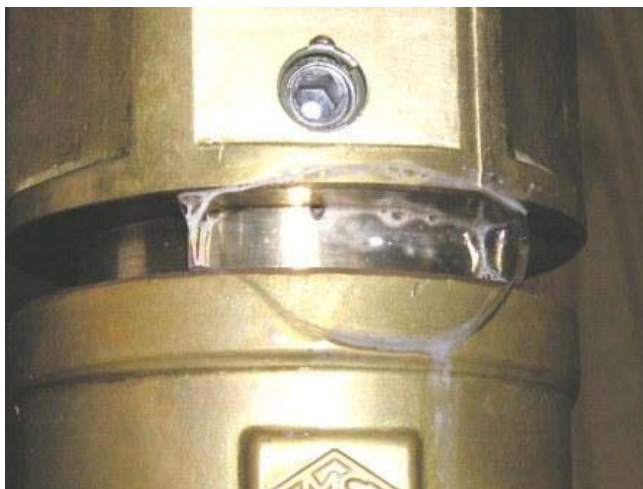
写真9 漏れ量が少ない状態
