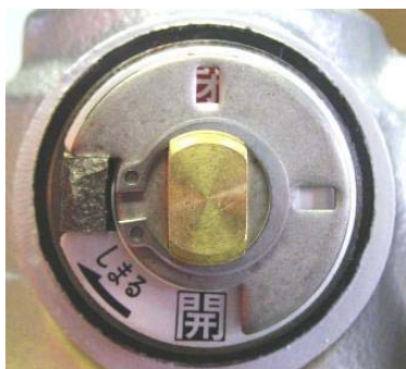
写真2 安全弁元弁「開」の状態
