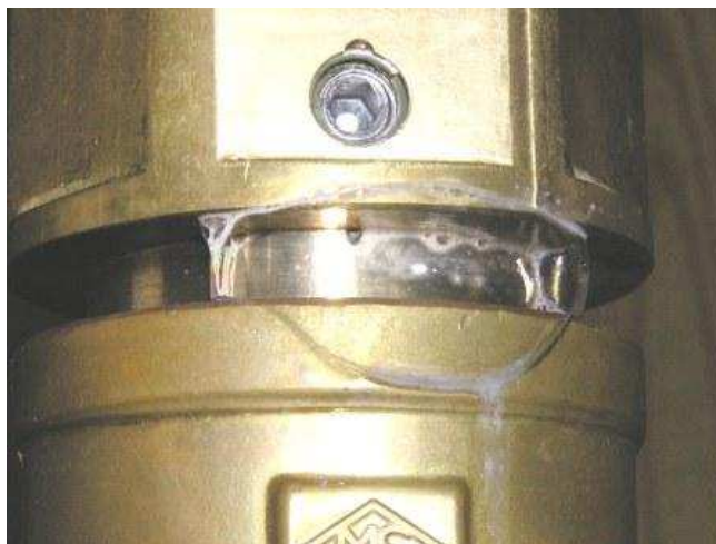
写真9 漏れ量が少ない状態
