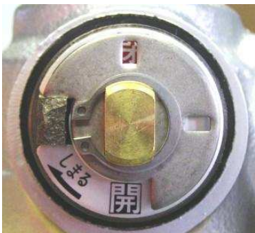
写真2 安全弁元弁「開」の状態
