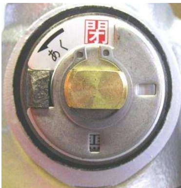
写真4 安全弁元弁「閉」の状態
