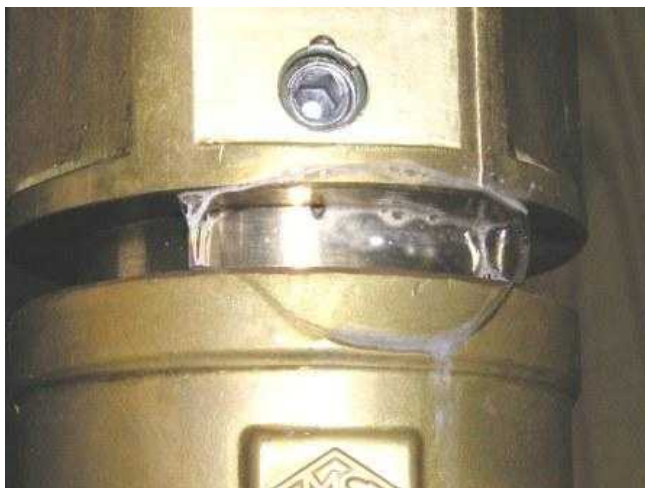
写真9 漏れ量が少ない状態
